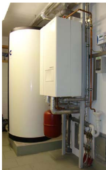
Solarspeicher mit Gasbrennwertgerät
