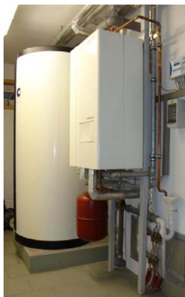
Accumulateur solaire avec brûleur au gaz
